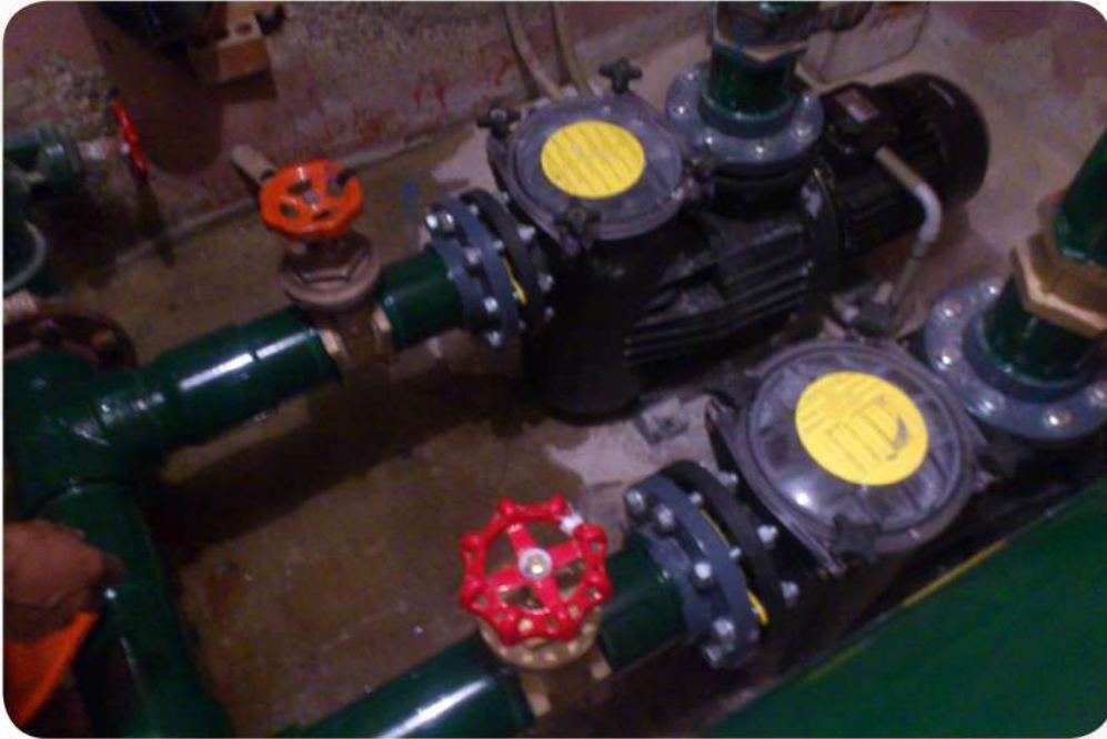
Bombas de recirculación de piscina 5 carriles
